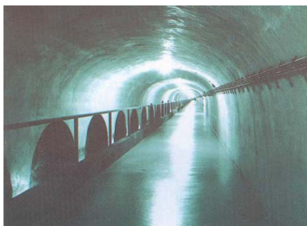
Galleria di captazione delle acque del Biferno, Rio Freddo
